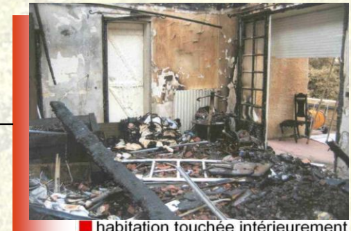
■ habitation touchée intérieurement
